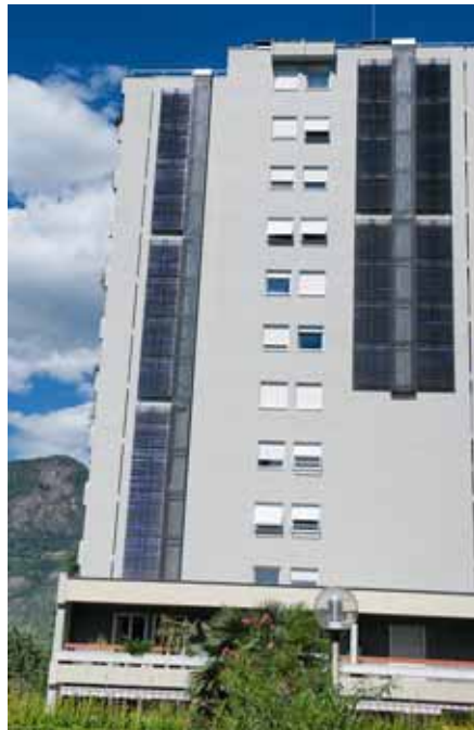
Ansicht des Gebäudes in der Europaallee mit den Sonnenkollektoren an der Fassade.
