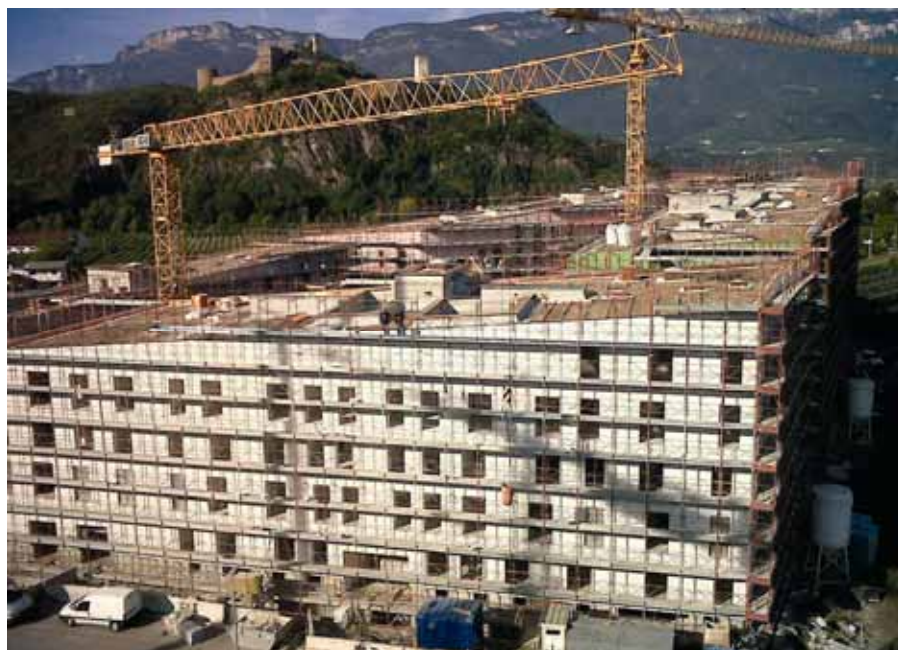
Baustelle des Bauloses EA1 in der Kaiserau in Bozen. Dort werden 159 Wohnungen gebaut und im Frühjahr 2011 fertiggestellt.
