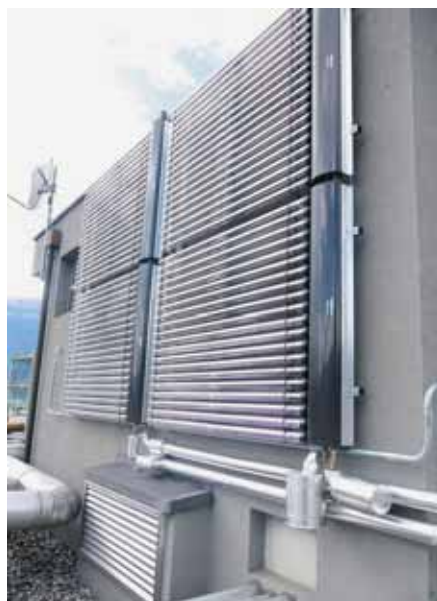
Detail der innovativen Solaranlage mit Röhrenkollektoren.
